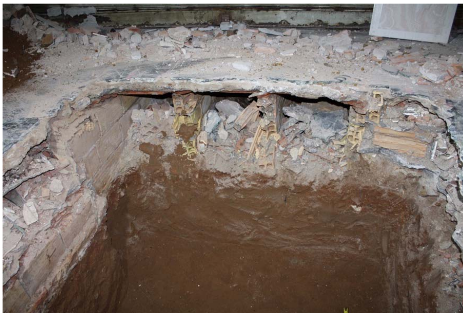
Foto 3: Vista del tall sud de la cala 1 amb UE 1000, UE 1001, UE 1002 i UE 1003.
