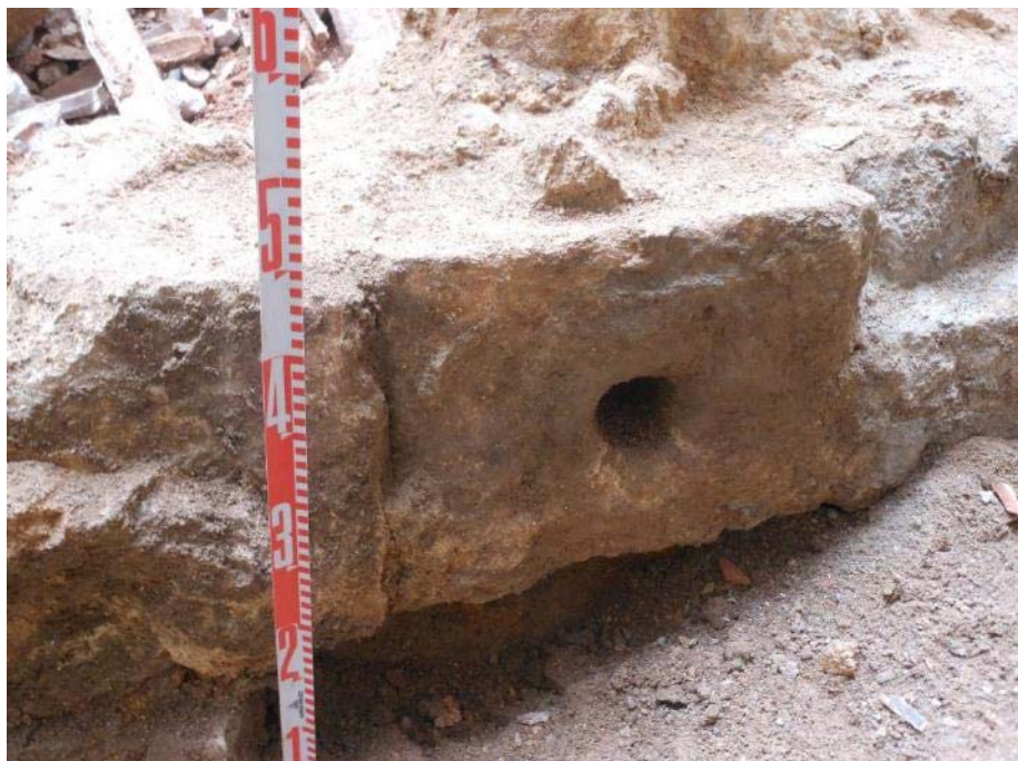
Fotografia 99: Vista d'un carreu reaprofitat com a fonamentació del mur UE 623 del convent de Valldonzella del segle XVII.
